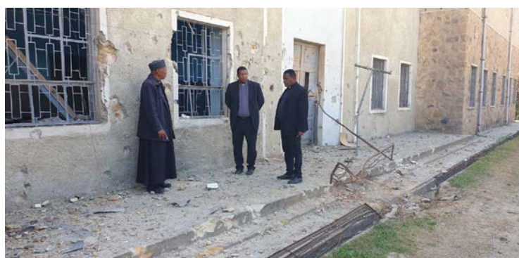
1. Una struttura dell'Eparchia di Adigrat danneggiata
